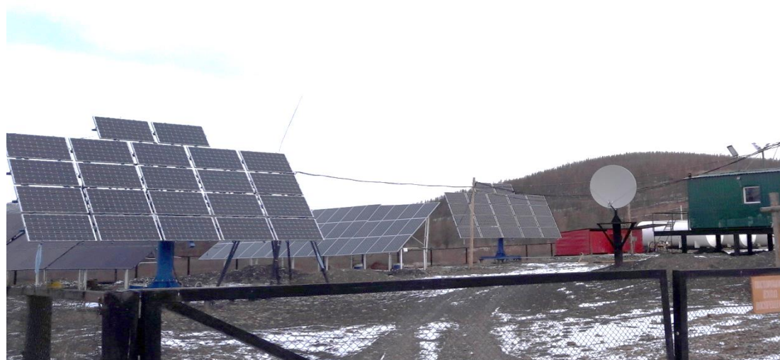
Рисунок 15. Общий вид солнечной электростанции в п. Ючюгей (на переднем плане трекер)
